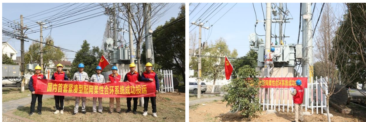
图：国内首套基于柔性移相调压技术的紧凑型配网不停电合环转供系统 在南京江宁滨江开发区投运
