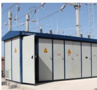
箱式分区所运行现场
