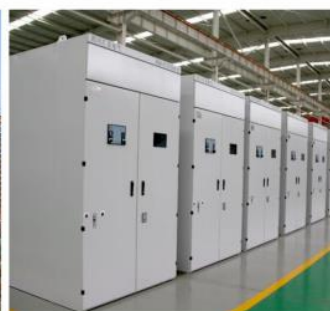
所用变保护负荷开关柜
