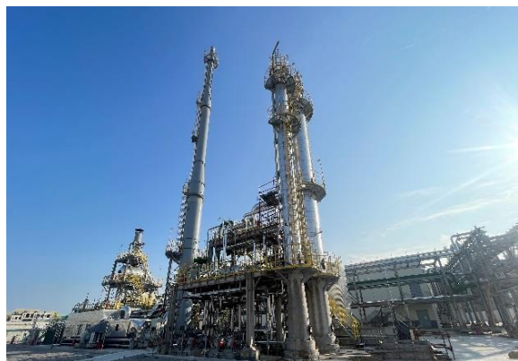
浙石化废气废液焚烧系统
